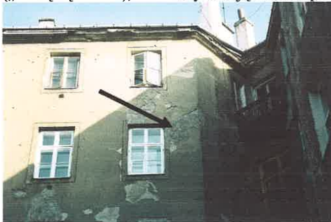
Rys.2. Ślad po zamurowanym wlocie pocisku na trzecim, przedostatnim piętrze.
